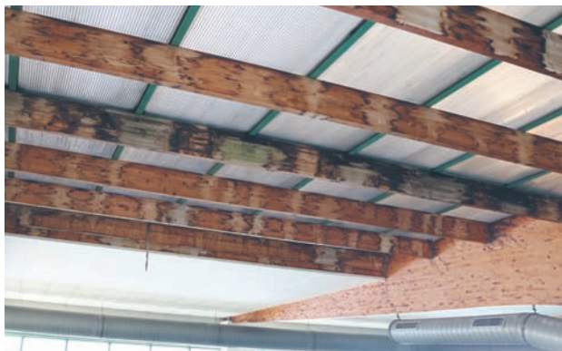
Dach basenu w Rudzie prawdopodobnie zostanie wyremontowany w przyszłym roku.
