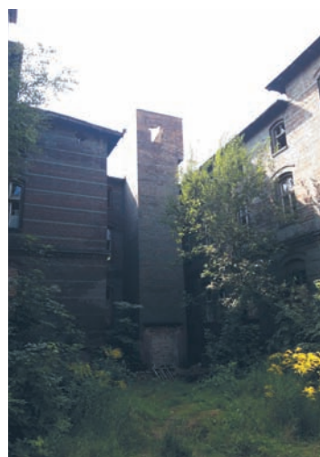
Bywają miejsca, gdzie zapadło się podłoże, a z górnych części budynku spadły cegły.
