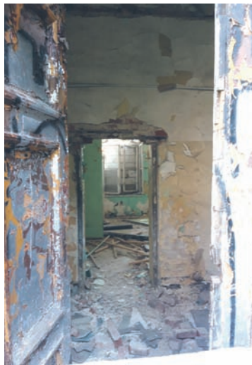
Obiekt powinien być zabezpieczony, ale dostęp do niego jest swobodny.
