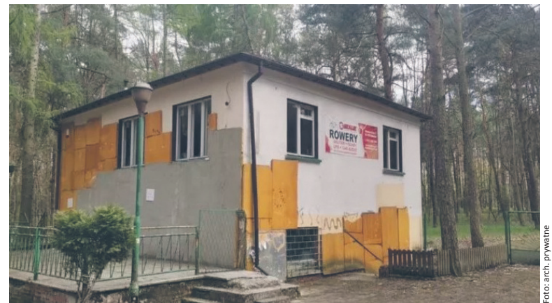
Miasto już dwa lata temu otrzymało wezwanie do rozbiórki „Borówki”.
