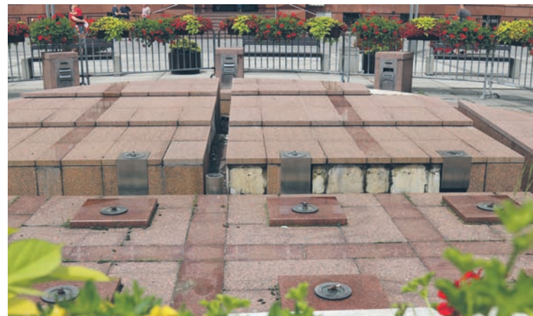
Remont fontanny na rynku konieczny jest m.in. z powodu uszkodzenia płyt.
