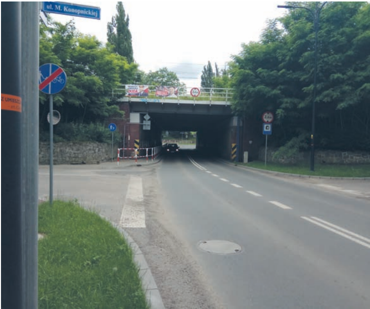
Pod wiaduktem przy ul. Piastowskiej jest nieka, co powoduje, że woda spływa tam z terenów położonych wyżej.
