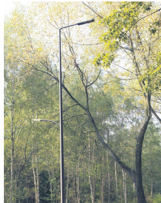
Na części słupów przy ul. Hallera zamontowano dodatkowe oprawy oświetlające chodnik.
