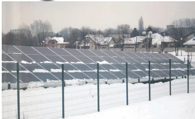
Dzięki nowym instalacjom obniżą się rachunki za prąd w trzech obiektach sportowych w mieście.
