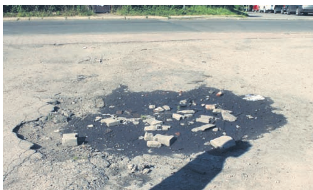
Duża dziura powoduje wiele niebezpiecznych sytuacji.
