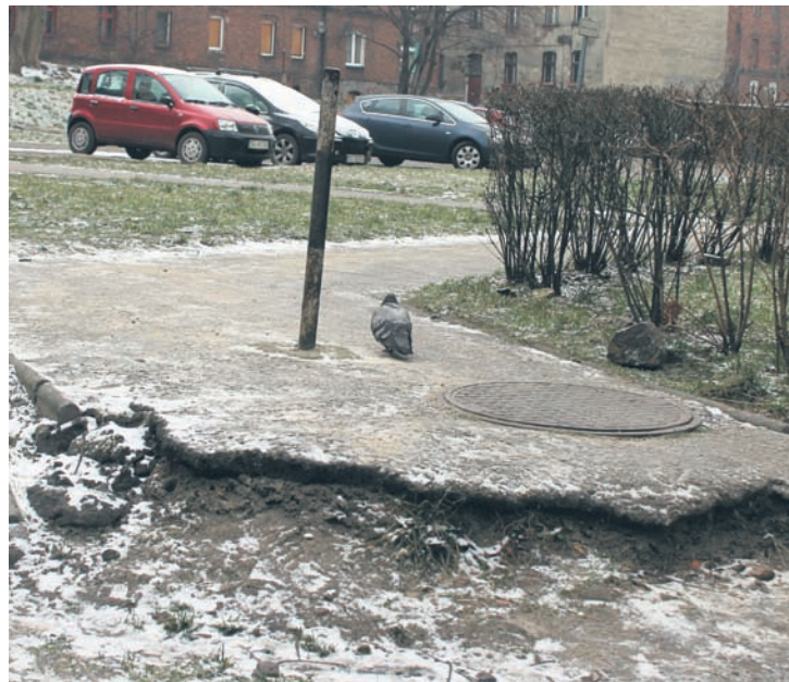
Chodnik biegnący obok bloku stojącego przy ul. Głównej 28 nagle się kończy.
