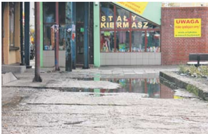
Tak chodnik wyglądał przed remontem.
