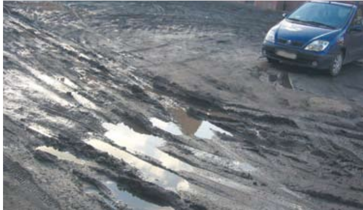
Przejście przez taki plac to dla mieszkańców wielkie wyzwanie.
